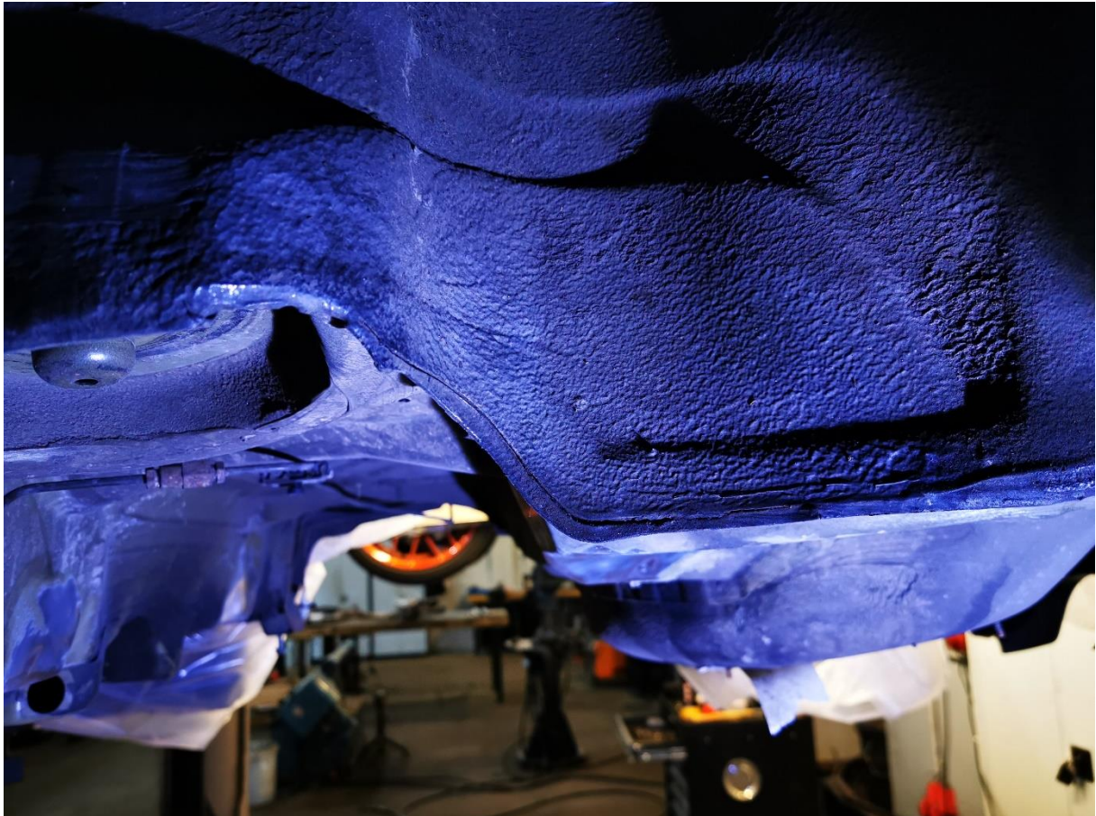
Bild Oben: Aufgeplatzte Punktschweißungen zwischen Bodengruppe und Radlauf, hier Ausnahmsweise sichtbar trotz Unterbodenschutz
